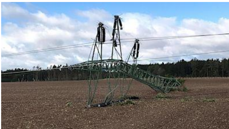
Jeden ze spadlých sloupů u Lišan na Rakovnicku.
